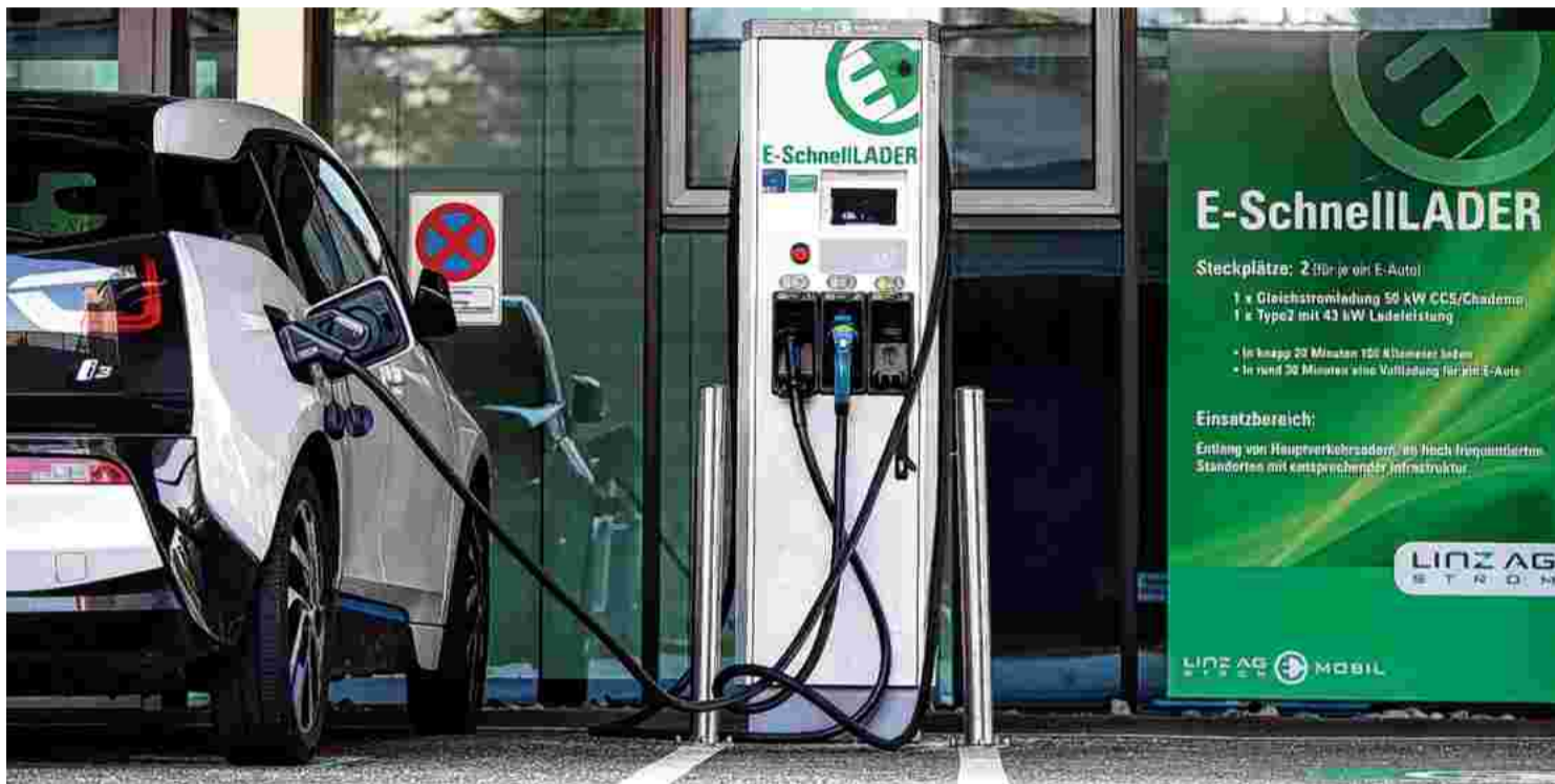
In Oberösterreich gibt es derzeit 194 Ladestationen, österreichweit sind es 1780 – mit insgesamt 4230 Normal- und Schnell-Ladepunkten. Foto: Weibold
