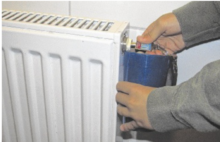
Regelmäßiges Entlüften von Heizkörpern erhöht die Heizleistung. Foto: KEM
