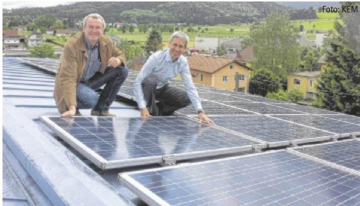
Christian Hummelbrunner und Horst Gaigg mit einer von 24 Photovoltaik-Anlagen auf öffentlichen Gebäuden, die die KEM Traunstein realisiert hat.
